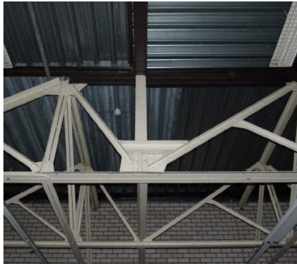
In sommige (oudere) delen van de sheddakhallen is de constructie verzaard om het golfplaten dak te kunnen dragen.
