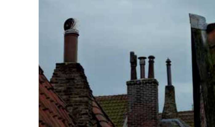
Luchtzuigers op ventilatiekanalen en schoorstenen
