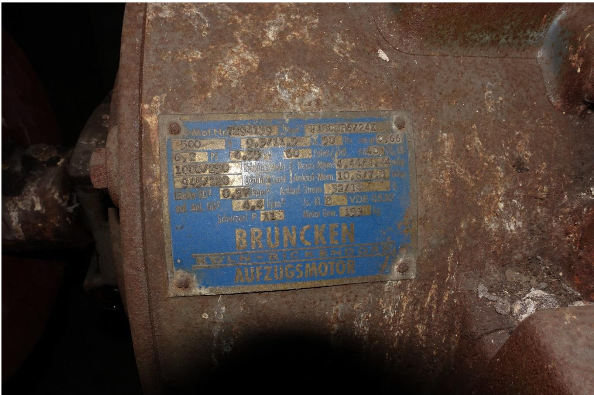
Liftmotor in gebouw 2, met op een stalen plaat vermelde specificaties.
